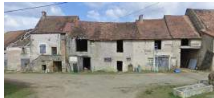
Bâti avec potentiel de réhabilitation, en cours de dégradation (St-André-le-Désert, Saint-Ythaire...).
